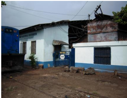
ナガ駅の車輛修理基地。外観からして基地そのものの老朽化の激しさが分かる。
