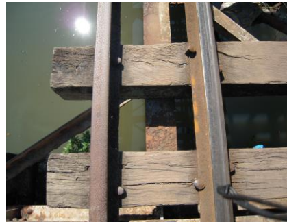
まだ木製枕木のままの、いかにも危険そうな鉄橋上の線路。
