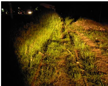
維持管理が行き届かず、土砂と草に埋もれた線路。
