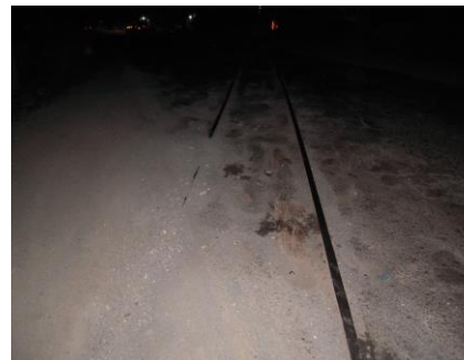
こちらも土砂に埋もれた線路(道路横断部分)
